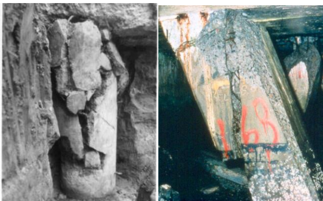
(c) Bending shear failure (d) Shear failure
