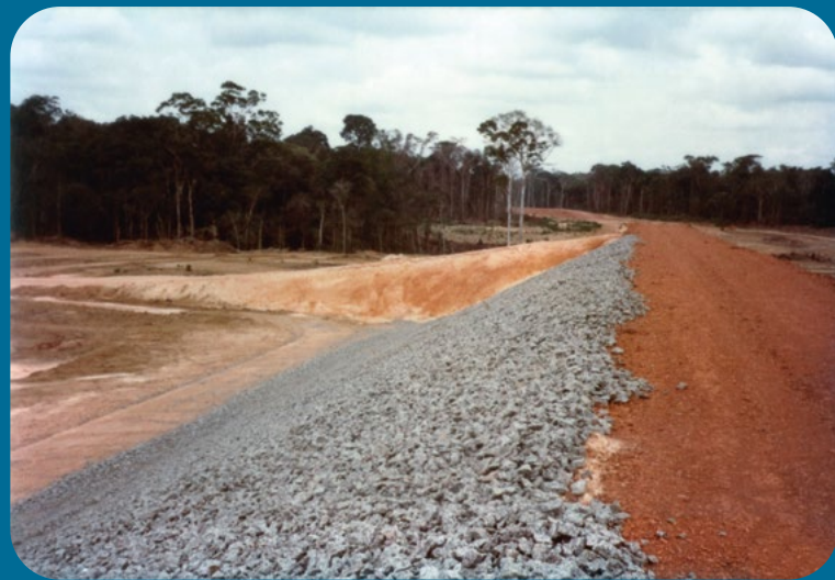
Barragem de Samuel no rio Jamarí, em Rondônia. Imagens apresentadas na reunião dos consultores em 1983: construção de um dos inúmeros diques de fechamento; desmatamento sem expurgo do solo orgânico; e fundação preparada para receber o primeiro tratamento. Na página ao lado, ilustração da barragem.
