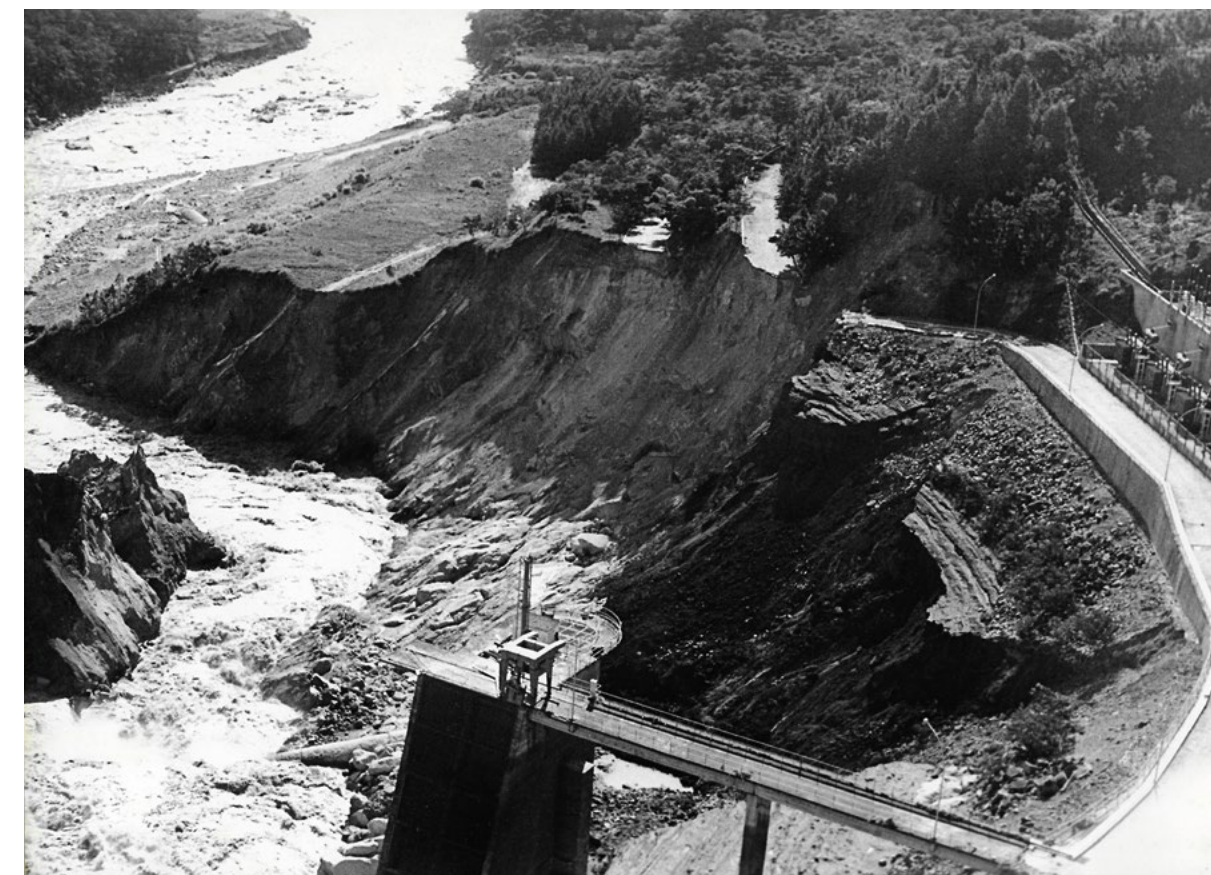
Vista área da ombreira direita da barragem de Euclides da Cunha após o rompimento, 1977.
