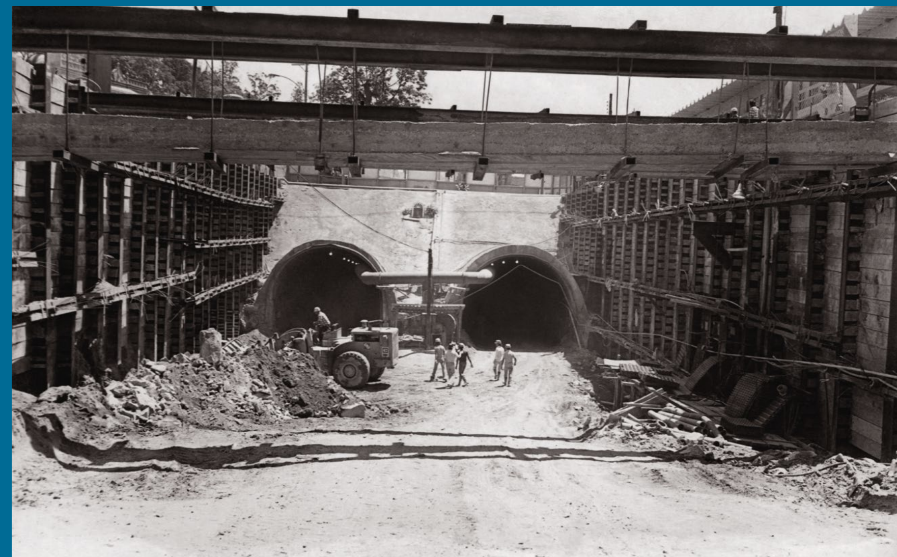
Na página ao lado, Victor com os amigos Oscar Vardé e Beth Décourt, anos 1990. Vardé trabalhou com Victor na barragem de Yacyretá, na Argentina. Acima, obras do metrô no centro da cidade do Rio, 1978.
