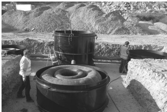
Figure 1. Installation du dispositif expérimental permettant l'ouverture progressive et concentrique d'une cavité circulaire sous le niveau du remblai renforcé.
