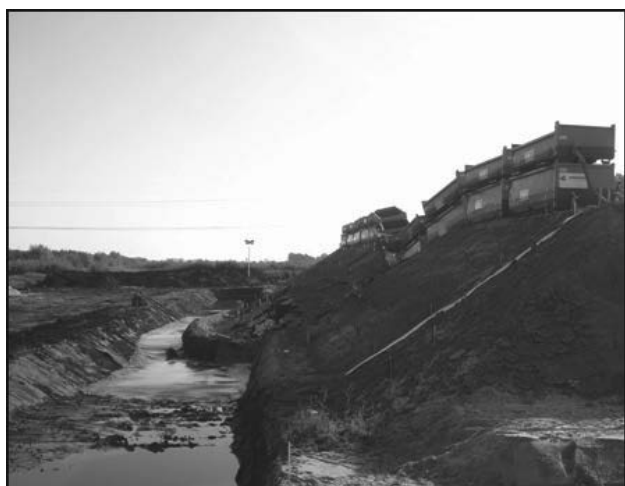
Figure 3 : Glissement de la digue (photo Koelewijn)
