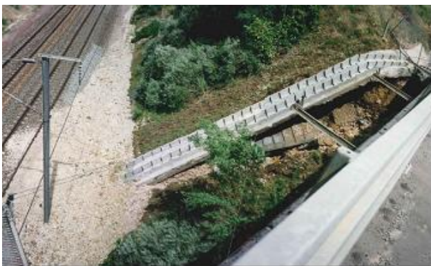
Photo 3 : Exemple d'incident sur la LGV Atlantique ayant eu des répercussions sur les circulations ferroviaires – érosion de talus aux abords d'une descente d'eau
