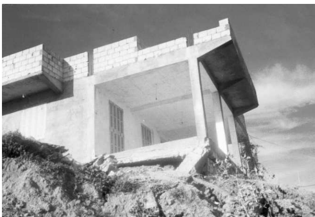
Figure 1 Vue sur la maison basculée
