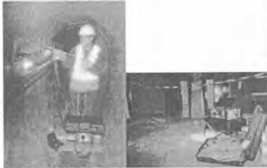
Figure 6. Exemple d'utilisation du matériel en situation réelle (en canalisation visitable et sur un sol industriel)
