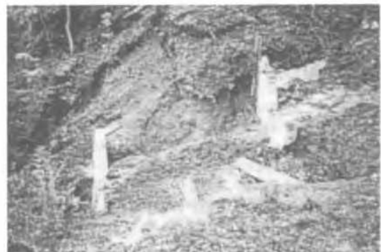
Figure 1 : Action d'une berge instable sur un barrage de correction torrentielle de type consolidation.
