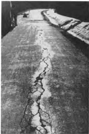
Fig. 2 Frost crack in a road, Germany (after A. Dücker). Fissure sur une route allemande (d'après A. Dücker).
