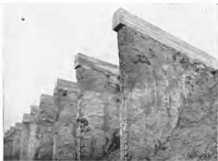
Fig. 9 Isola Serafini power station. Power station diaphragm. Supporting abutments. Aménagement d'Isola Serafini. Mur diaphragme de l'usine. Culées de support.
