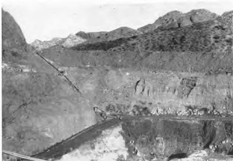
Fig. 5 Vue d'aval une fois l'excavation achevée. View from downstream at end of excavation.
