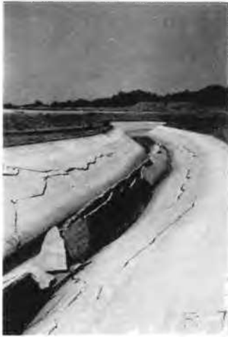
Fig. 7 Disrupted lining. Tablazo Canal. Revêtement fissuré. Canal du Tablazo.
