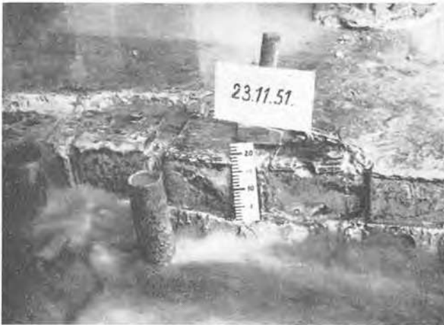
Fig. 8 Soulèvement de la dalle de fondation par rapport aux palplanches Raising of the Foundation Slab in Comparison with the Sheet Piling
