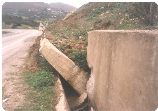
Effondrement de mur de soutènement après plusieurs années
