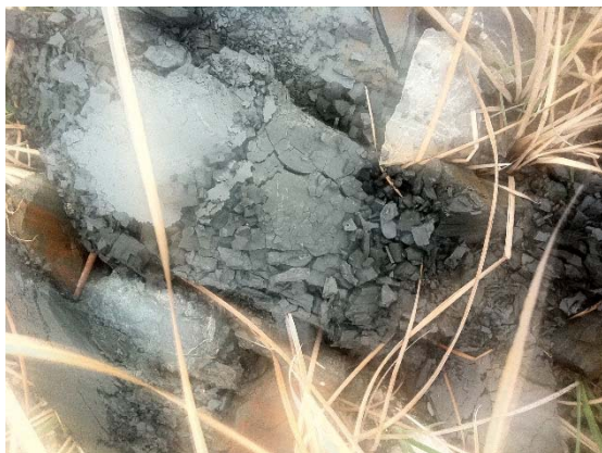
Silite en cours d'effritement
