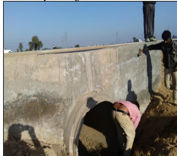
Fig 5 (d) Investigation for construction deficiency
