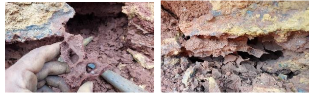
Figura 6: Níveis erodidos confinados no topo do talude, abertos na escavação em Agosto - 2022.
