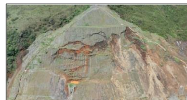
Figura 1: Escorregamentos sequenciados no talude após período chuvoso mais intenso do verão de 2021. Foto de Fevereiro de 2022.
