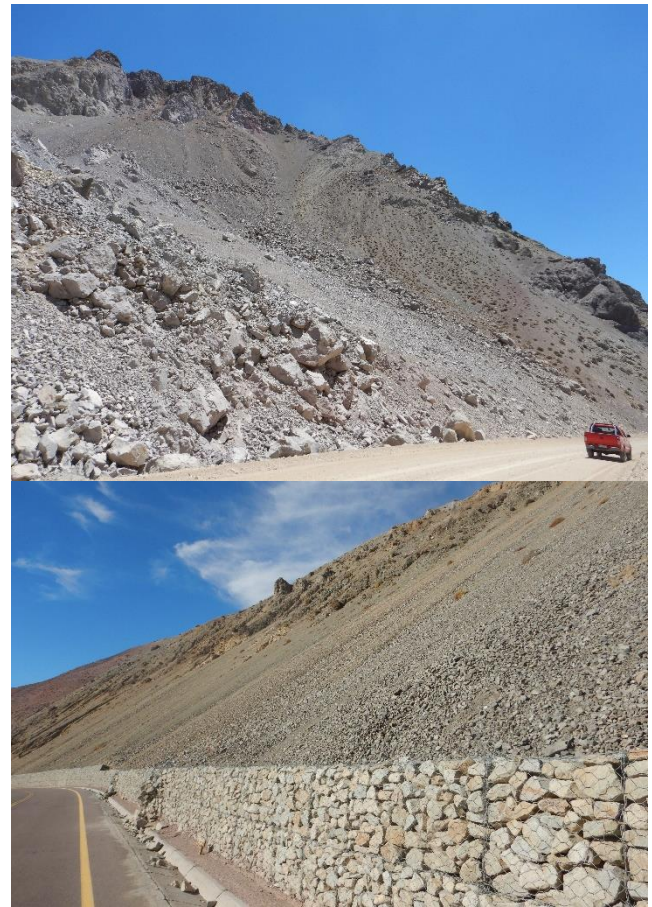
Figura 7. Procesos gravitacionales de laderas asociados a deslizamiento de roca en zonas con fallas geológicas y alteración hidrotermal (arriba) y caídas de rocas recurrentes en sectores del tramo inferior (pavimentado) donde existen medidas de mitigación en coluvios (conos de talud).
