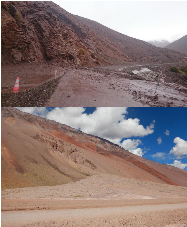
Figura 8. Flujos de detritos que afectan recurrentemente la ruta 41 Ch. Se observa variabilidad en los detritos y extensión de los abanicos, además de la fuente de sedimentos que aporta material desde las laderas.
