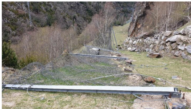
Figura 8. Barrera destruida por un impacto de rocas que, aunque no muy grandes, arrancaron los anclajes al estar estos cimentados sobre un vertedero de cenizas
