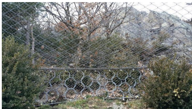
Figura 5. Ejemplo de un panel inferior para el cierre de una pequeña depresión con dos tipologías de malla distintas; esto no está permitido y la barrera debería de considerarse no apta o con fallo de instalación y sin certificado
