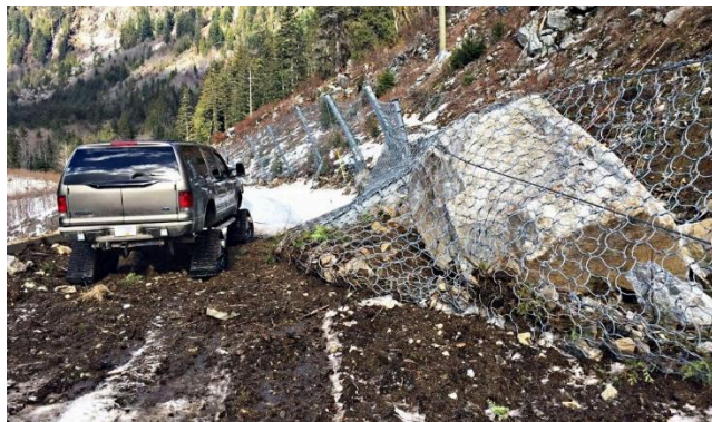
Figura 7. Barrera afectada por el impacto de grandes bloques
