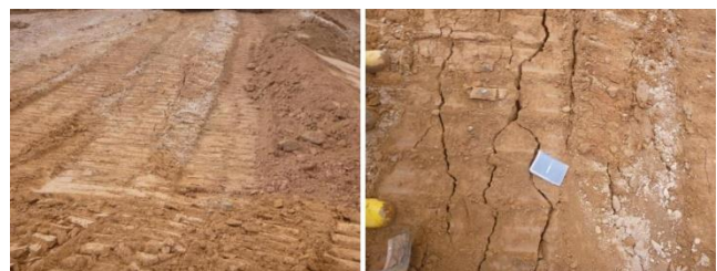
Imagen 5. El sapolito colocado encima del sapolito más húmedo. Nota: Se evidenció signos de agrietamiento (10 m x 3 m de tamaño). El relleno fue retirado posteriormente.
