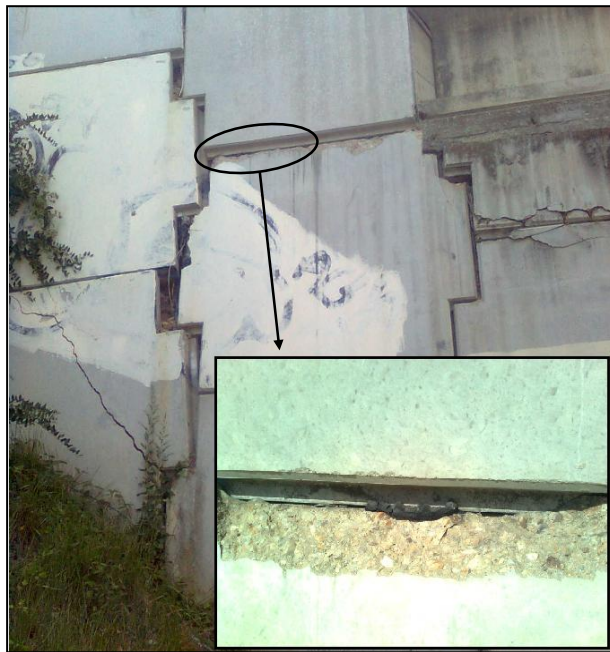
Figure 1. Muro de tierra reforzada, con patologías de desconchamiento debido a desplazamientos relativos excesivos entre paneles del paramento.
