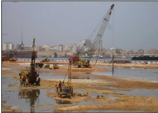
Figure 8. Vue des ateliers de forages de contrôle
