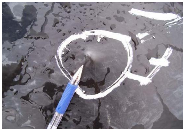
Figura 4. Daños encontrados en la geomembrana
