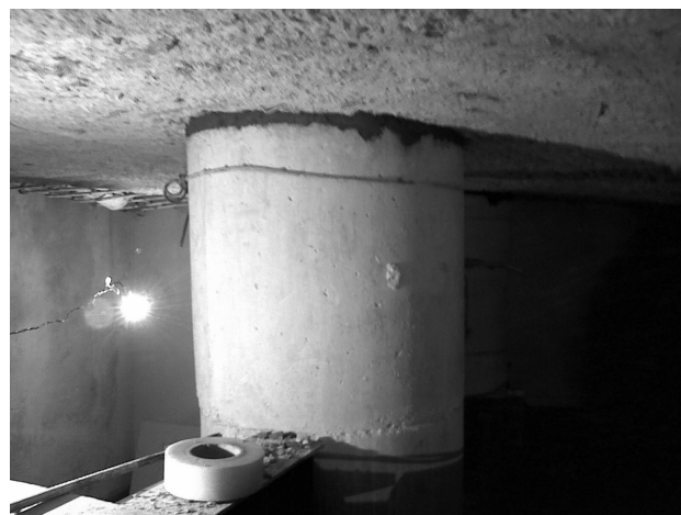
Figura 22. Se muestra la colocación del grout sobre la superficie superior del pilote para recibir nuevamente a la zapata de cimentación.
