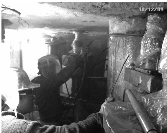
Figura 21. Nuevamente se pueden apreciar los trabajos de corte muy preciso bajo zapatas.
