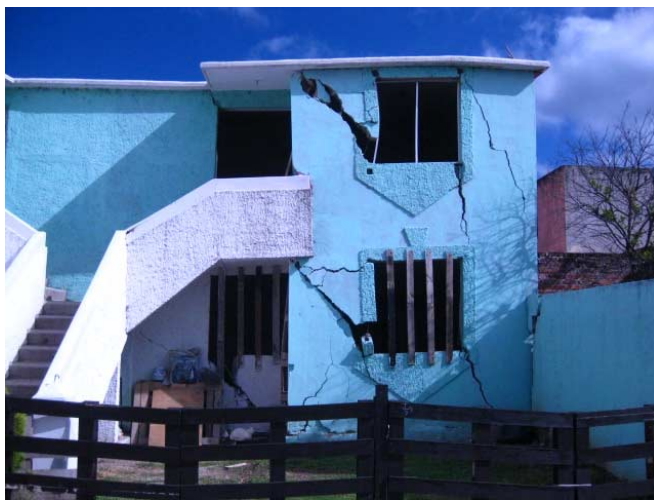
Figura 1. Casa habitación afectada por el fallamiento activo de la Ciudad de Irapuato.
