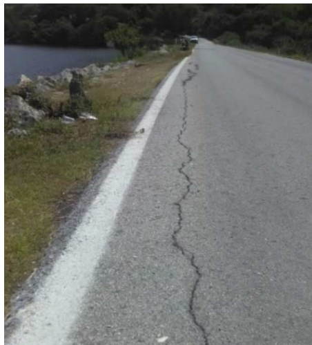
Figura 5. Agrietamiento en carpeta asfáltica de Huitzuco, Gro.
