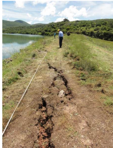
Figura 8. Presa Huauchinantla, Pue., agrietamiento y desplazamiento del enrocamiento.
