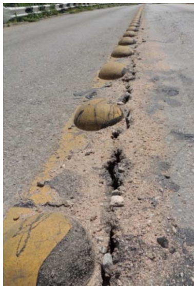
Figura 2. Detalle del agrietamiento inicial La Angostura
