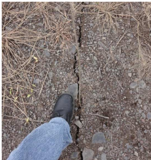
Figura 3. Grieta en Barreto, Mor.
