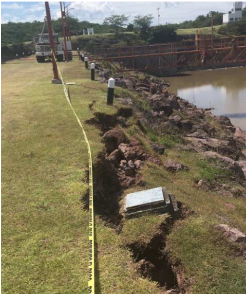
Figura 7. Presa Tierra y Libertad, Mor., desplazamiento del enrocamiento.
