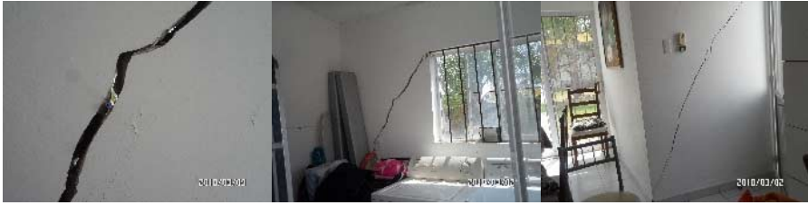
Figura 1. Estructuras considerablemente dañadas por el fenómeno expansión – contracción.
